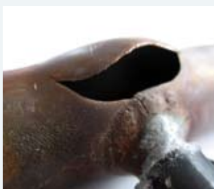
Frostschaden am Sammlerrohr
